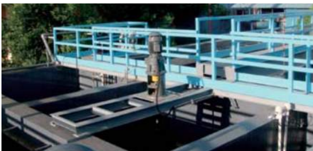
Acque di scarico
